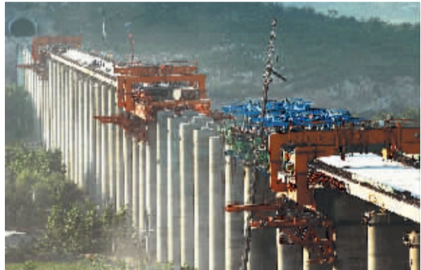
采用移动架梁造桥机施工中的石太客运专线治河特大桥。
